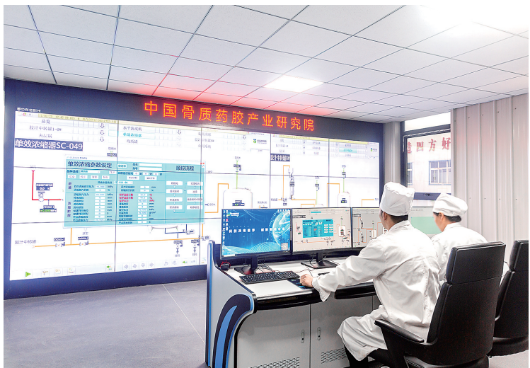
在四方药业中央控制室,生产线运行状态、设备实时工况、物料处理进度、车间温湿度及核心工艺参数等数据实时更新。
